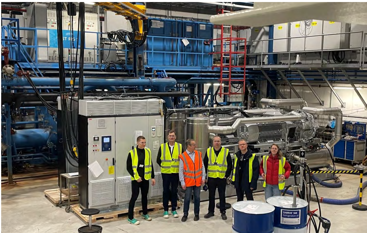
Og varmepumpen er ankommet
