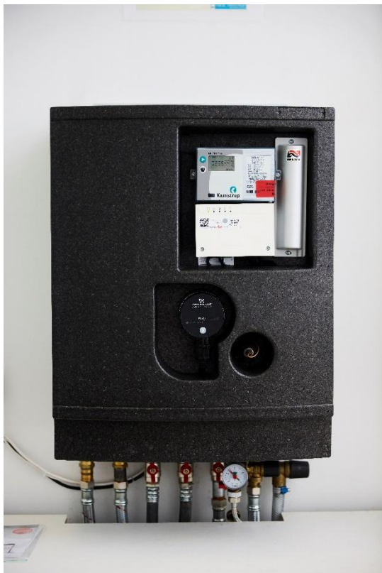
Fjernvarmeanlæg på abonnement
