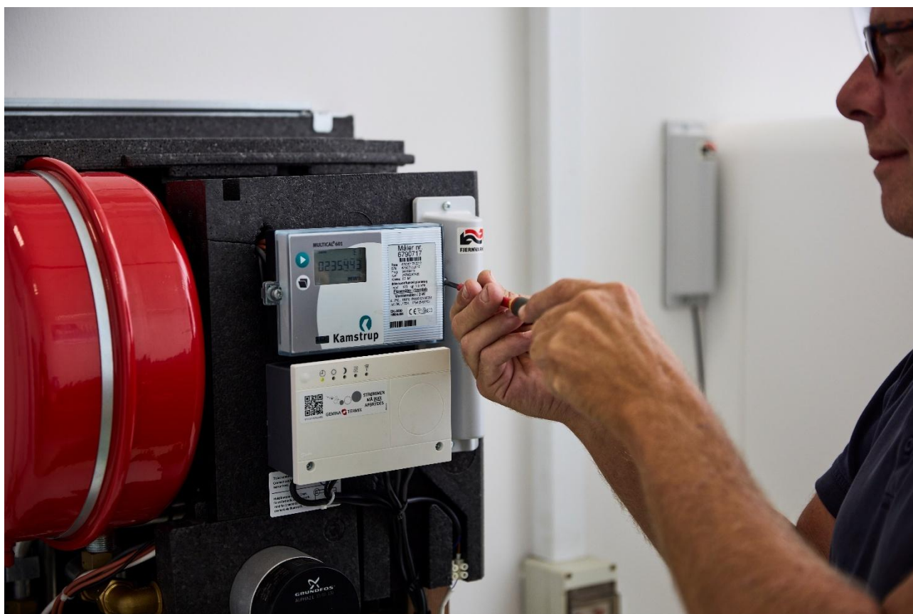
Opsætning af fjernvarmemåler
