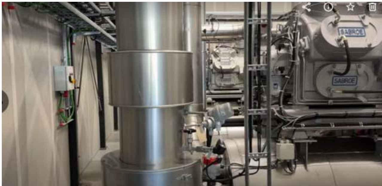
Varmepumpe hos GlobalConnect
